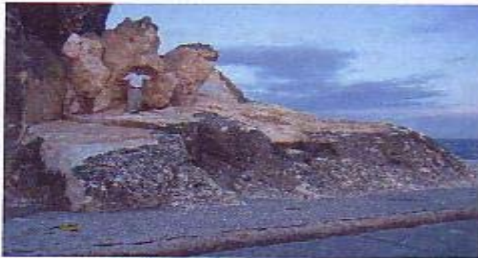
岩塊の剥離場所
